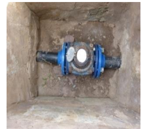
Compteur de l'adduction d'eau
